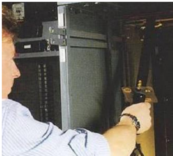
Testowanie w rozdzielniczy
